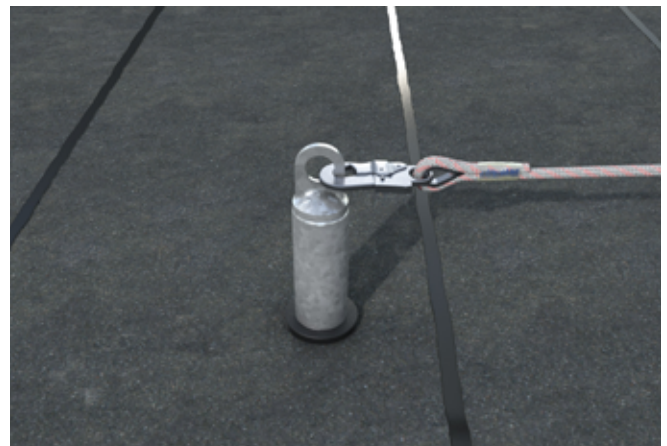
Abb. 57 Beispiel einer Anschlageinrichtung, die dauerhaft am Bauwerk befestigt ist (Einzelanschlagpunkt-Stahlrohrstütze).
